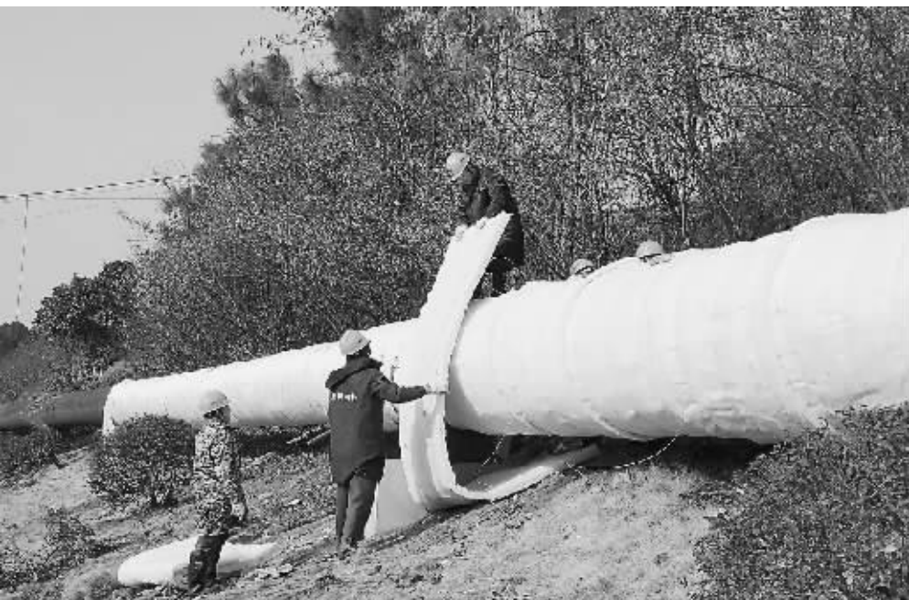
据了解,武汉、合肥、长沙等城市的部分城区已开始实行冬季集中供暖,也有地方正在规划建设供暖项目。图为在安徽省巢湖市,工人为供暖管道包扎玻璃棉保温材料。 CNSPHOTO 提供
