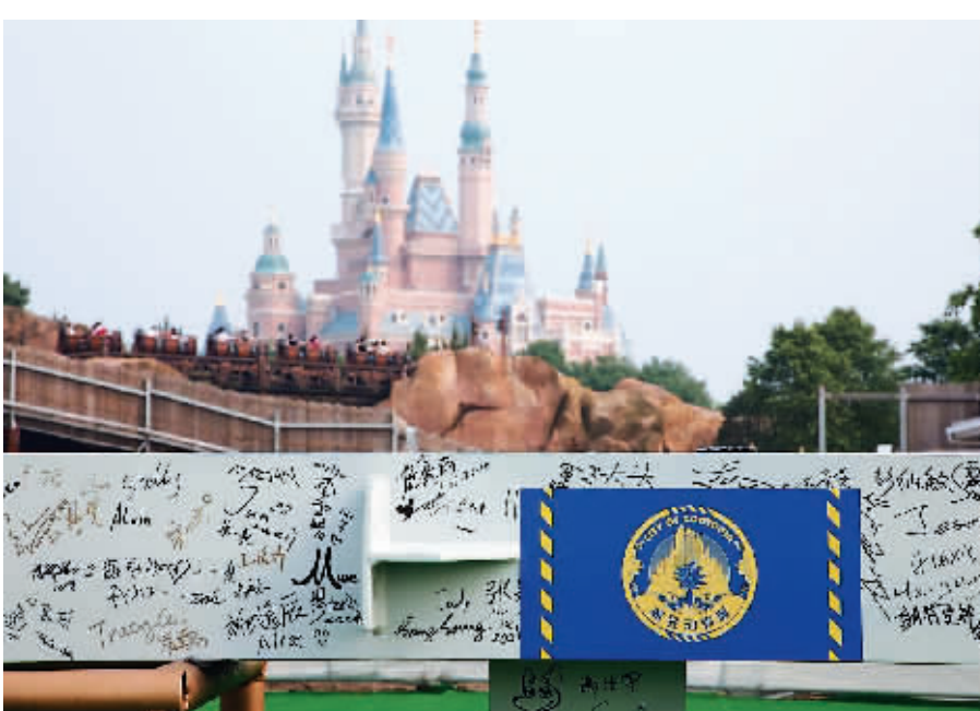
6月8日,上海迪士尼乐园的全新主题园区“疯狂动物城”的首根钢结构柱完成安装,标志着这一新园区的地上建设正式启动。在首根钢结构柱安装之前,来自上海迪士尼度假区、上海国际旅游度假区管委会、上海申迪(集团)有限公司以及负责该主题园区设计和开发工作的华特迪士尼幻想工程的管理层人员与员工们纷纷在钢结构柱上签名留念。 李蓓君/摄
