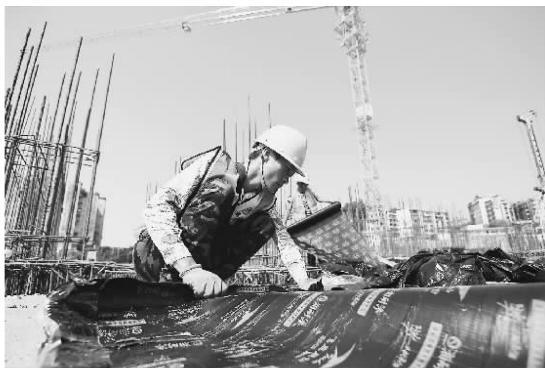
近年来,各地大力推进城市功能品质更新。图为工人正在某项目施工现场铺防水材料。
